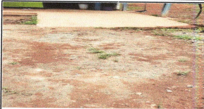
Foto 1: Losa de patio frente a módulo de aulas en mal estado
