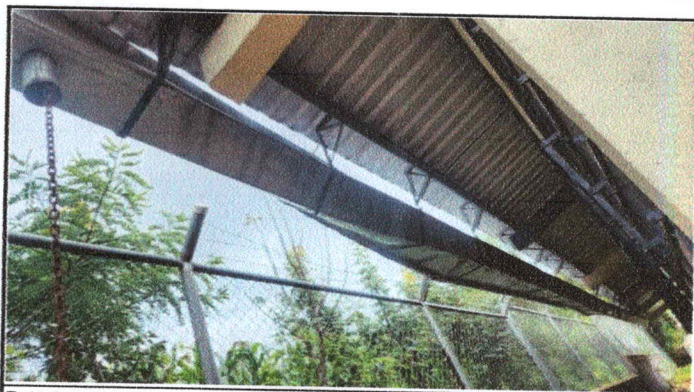
Foto 9: soportes de canales dañados, canales no cumplen la función de evacuar correctamente el agua pluvial.
