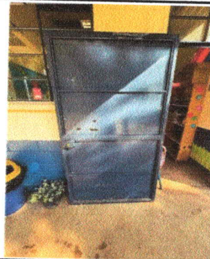
Foto 8: Puertas deniveladas + chapas dañadas.
