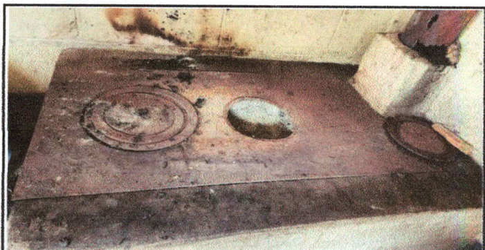
Foto 5: Área de cocina: pollo fuego en mal estado
