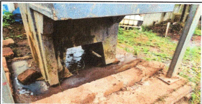
Foto 3: Área de pila, losa de patio y sistema de drenaje en mal estado
