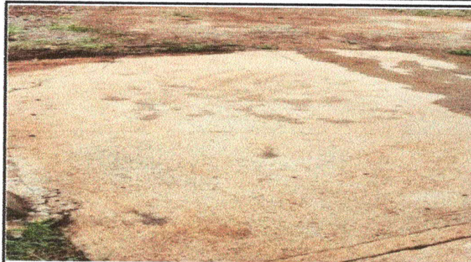
Foto 2: Losa de patio en mal estado, frente al módulo de cocina
