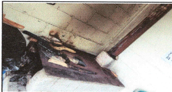
Foto 6: Área de cocina: chimenea en mal estado
