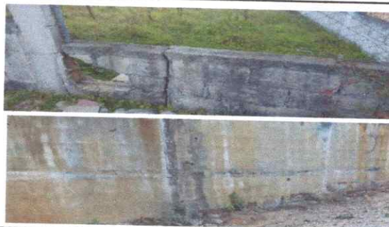
Foto 2: es necesario sustituir el muro ya que esta a punto de colapsar, para mejor seguridad de los estudiantes,
