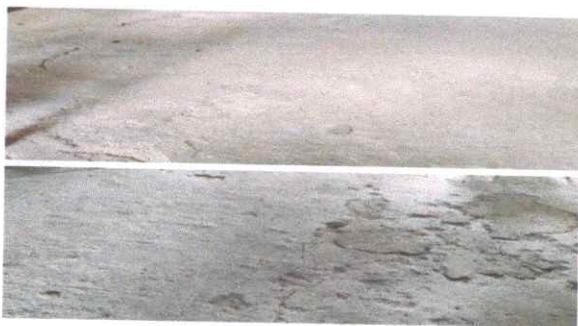
Foto 3: es necesario de sustituir la losa del patio ya que esta super deteriorada.
