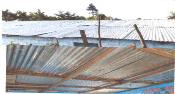
Foto 1: En las fotografías se aprecia la necesidad de sustituir el techo del Centro Educativo NUFED, para evitar que se cuele el agua en el invierno ya que por donde quiera se cuele.
