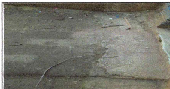
Foto 6: LOSA DE PATIO EN MALAS CONDICIONES
