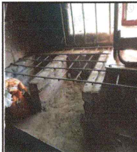
Foto 2: SE NECESITA REPARACION EN EL AREA DE COCINA.
