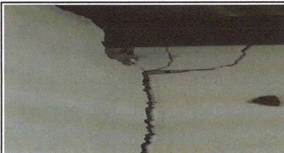
Foto 3: SE NECESITA SUSTITUCION DE REPELLO Y CERNIDO
