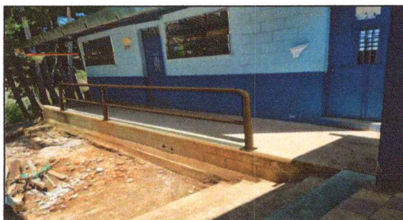
Foto 4: SE OBSERVA BARANDA EN MAL ESTADO
