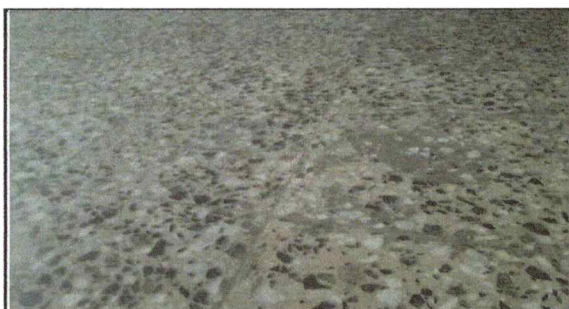
Foto 3: PISO DE GRANITO EN MALAS CONDICIONES
