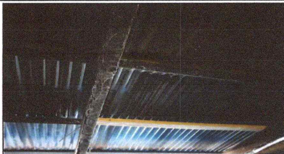
Foto 2: SE APRECIA LA ESTRUCTURA DE MADERA EN MAL ESTADO
