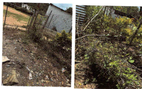
Foto 4: Daño en el muro perimetral
