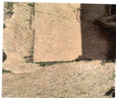
Foto 1: losa de patio dañada que es un peligro para los niños
