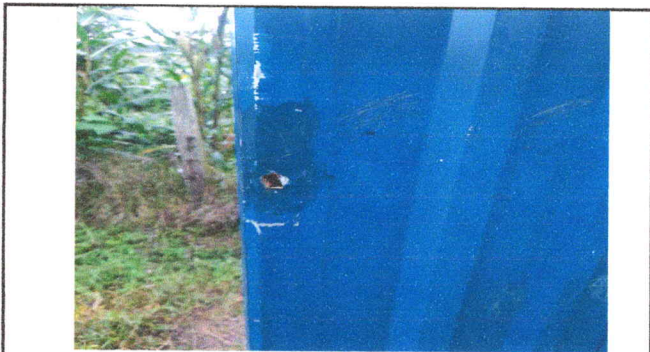
Foto 3: EVIDENCIA DE PORTON CON AGUJEROS Y LAMINA DESPEGADA.
