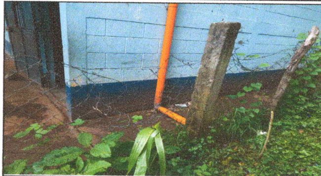
Foto1: EVIDENCIA DE CERCO DE MALLA DETERIORADO.
