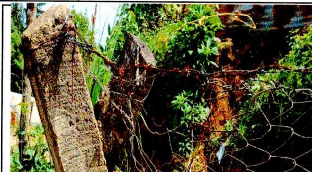
Foto 2: SE OBSERVA CIMIENTOS DE LAS COLUMNAS HAN COLAPSADO, INGRESA MUCHA CORRIENTE DE AGUA CON LODO
