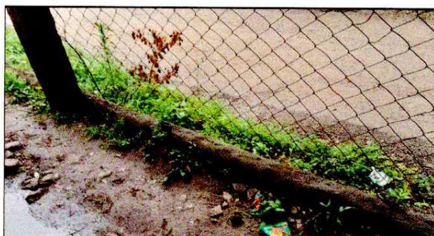
Foto 4: SE OBSERVAN CIMIENTOS
