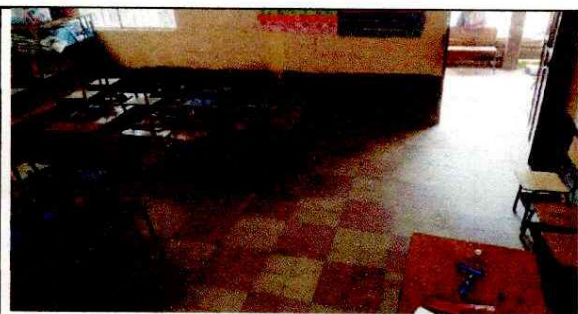
Foto 3: piso en aulas demasiado rayado por la antigüedad y uso
