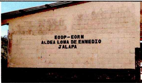
Foto 7: Presenta desgaste de pintura en los muros exteriores
