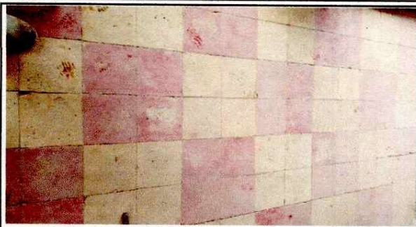
Foto 1: Presenta daños por el tiempo de uso
