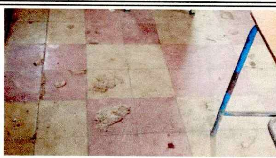
Foto 2: presenta escabaciones que acumulan suciedad
