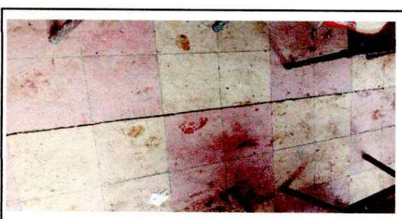
Foto 6: Dificultad para su limpieza por las grietas
