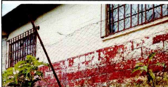
Foto 4: pintura presenta descascaramiento
