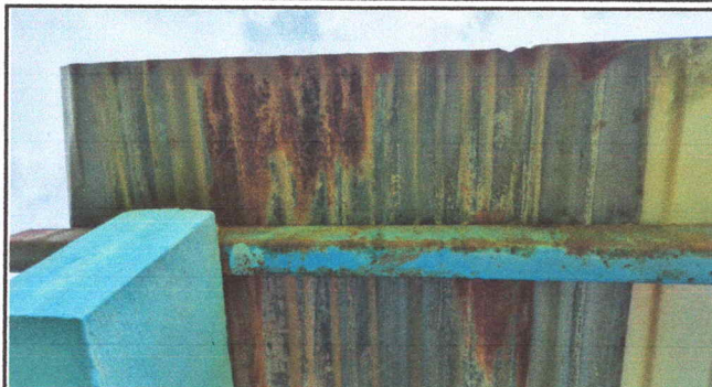
Foto1: SE OBSERVA LAMINA EN MAL ESTADO
