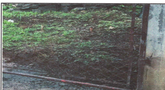
Foto 4: SE OBSERVA PORTON EN MAL ESTADO
