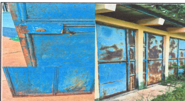
Foto 3: SE OBSERVAN PUERTAS DE BAÑOS Y DE AULA EN MALAS CONDICIONES
