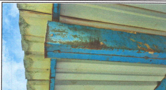
Foto 2: SE APRECIA LA ESTRUCTURA DE METAL EN MAL ESTADO
