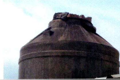
Cambio de Tanque de agua por mal estado.
