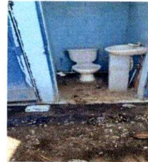
Foto 4: Sustrucción de baños dañados
