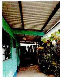
Foto 6: Cambio de Canales y bajadas en mal estado.
