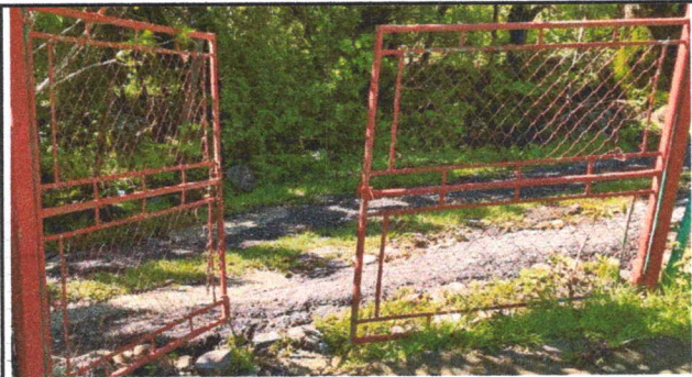
Foto 3: El porton de acceso requiere reparación y mantenimiento.
