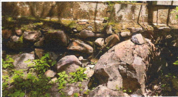
Foto 1: Muro de concreto deficiente, debe ser sustituido.
