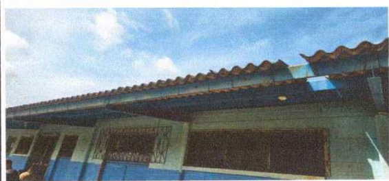
Foto 1: Techo Viejo en malas condiciones.
