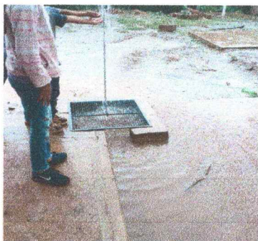
Foto 3: CAPACIDAD DE DRENAJE DE AGUAS PLUVIALES LIMITADA
