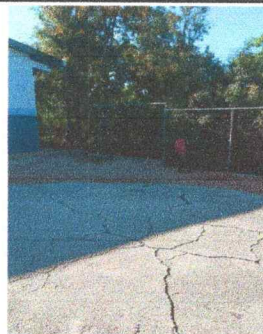
Foto 2: LOSA DE PATIO CON GRIETAS Y HUNDIMIENTO
