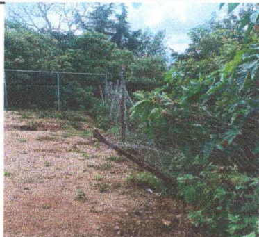
Foto 1: CERCO PERIMETRAL EN MAL ESTADO
