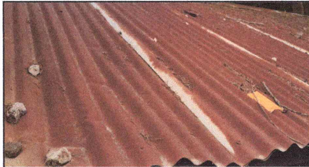
Foto 1: LAMINA EN MAL ESTADO
