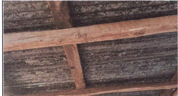
Foto 2: SE OBSERVA ESTRUCTURA EN MALAS CONDICIONES
