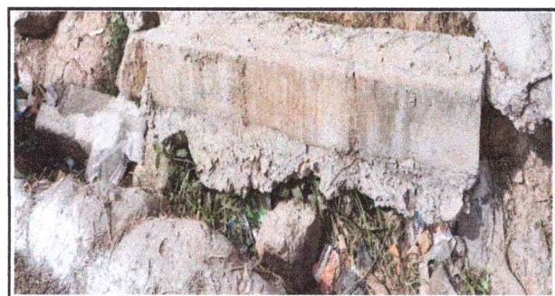
Foto 6: MURO PERIMETRAL EN MALAS CONDICIONES
