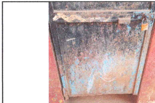
Foto 3: ES NECESARIO SUSTITUIR LAS PUERTAS
