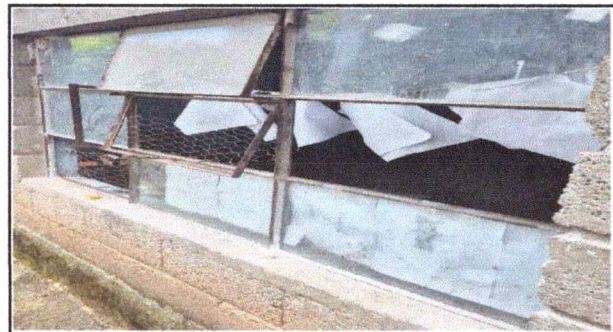
Foto 4: ES NECESARIO SUSTITUIR VENTANAS
