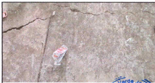
Foto 5: PISO DE CEMENTO SE OBSERVA RAJADO
