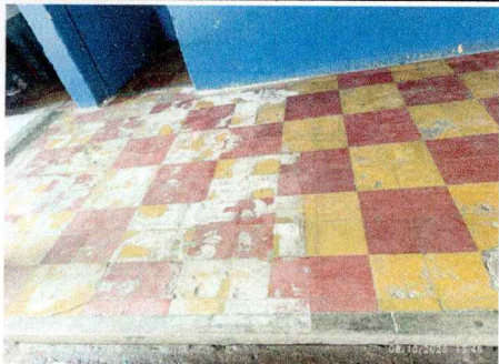
Foto1: Sustrución de piso en mal estado.
