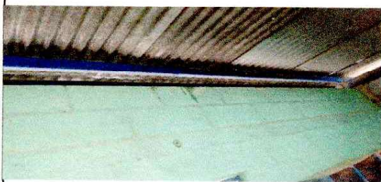
sustitucion de lámina, Techo con muchas goteras
