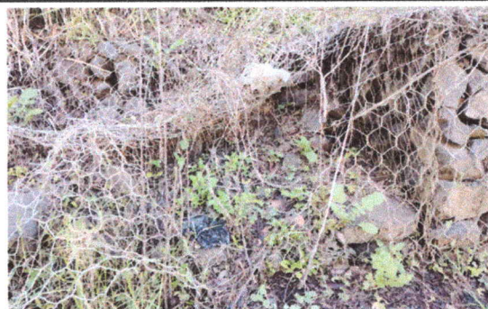
Situacion de gaviones
