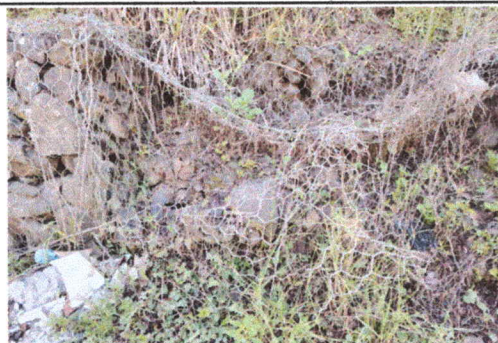
Situacion de gaviones
