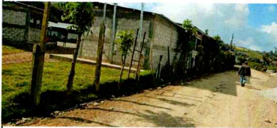
Foto 1: Por seguridad es necesario reparar el cerco de la escuela.
