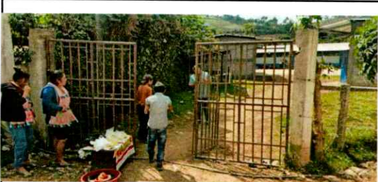
Foto 3: Porton principal en mal estado.
