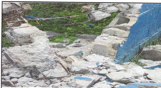
Foto 3: CERCO PERIMETRAL CON BLOCK Y MALLA EN MAL ESTADO
