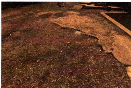
Foto 1: losa de patio dañada que es un peligro para los niños
