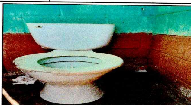
Foto 2: SANITARIOS EN MAL ESTADO
