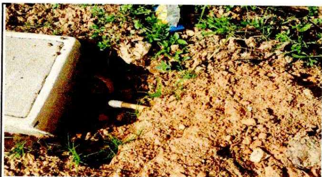
Foto 3: ES NECESARIO SUSTITUIR RED DE AGUA POTABLE
