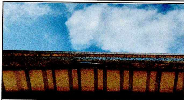
Foto1: SE OBSERVA CANAL EN MAL ESTADO
