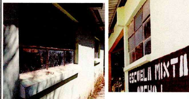
Foto 4: VENTANALES Y VIDRIOS
