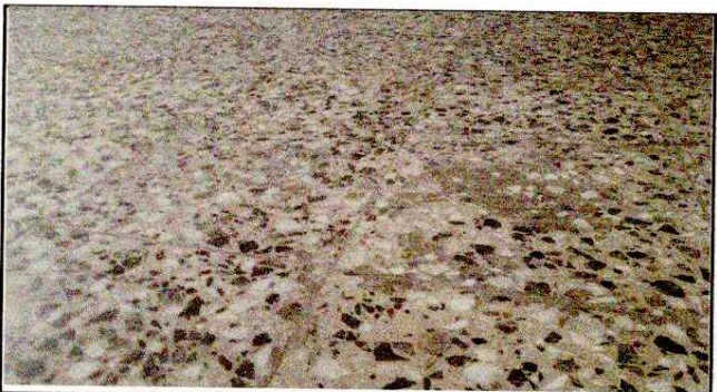
Foto 3: PISO DE GRANITO EN MALAS CONDICIONES
