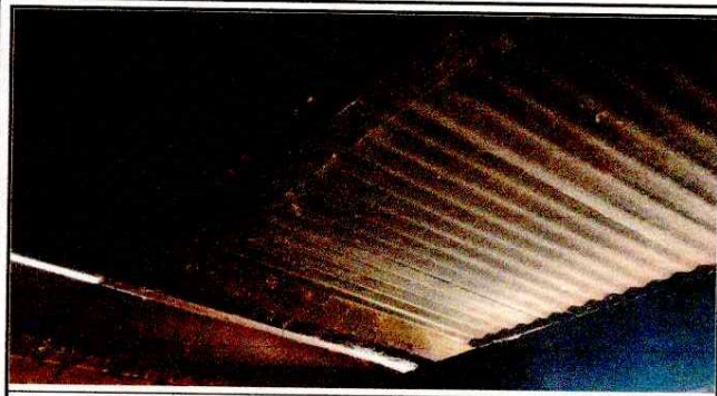
Foto 1: SE OBSERVA LAMINA CON AGUJEROS Y BASTANTE OXIDADA
