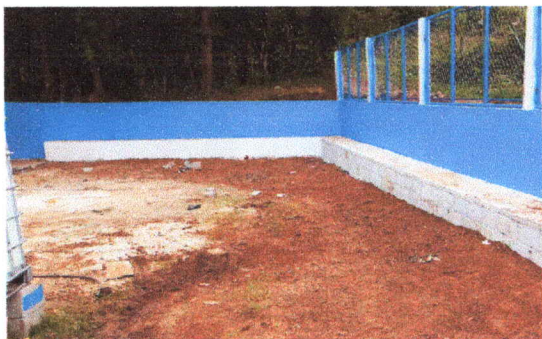
Foto 1: Se Observa ausencia de circulación, es necesario colocar malla.
