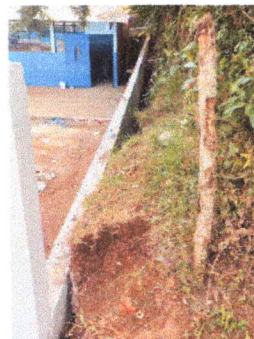
Foto 2: se observa circulación incompleta, es necesario tapar para evitar el acceso de terceros.
