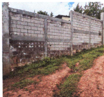
Foto 3: Se observa muro Perimetral en mal estado.
