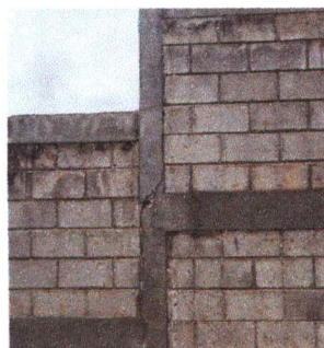
Foto 4: Por los sismos, el muro a sufrido fracturas la cual necesita una atención prioritaria.
