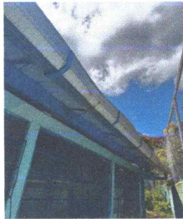
Foto 3: daño en el canal de evacuacion de agua pluvial y en las bajadas
