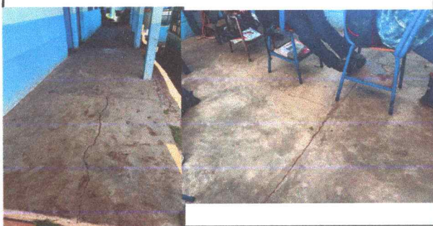
Foto 1: Losa de patio dañada
