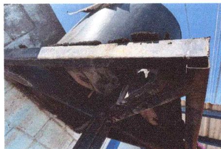
Foto 4: Reparación soporte de deposito de agua en malas condiciones
