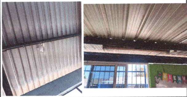
Foto 2: Lámina que necesita cambio y red electrica dañada
