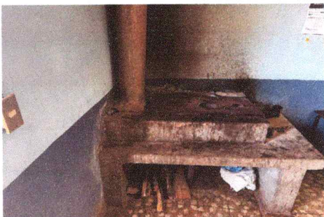
Foto1: Cocina en malas condiciones.
