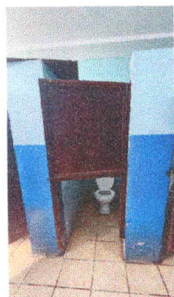
Foto 1: SUSTICION DE PUERTA DE BAÑO (0.80*1.00cms)
