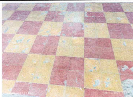
Foto 1: Sustrucción de piso por estar muy deteriorado.
