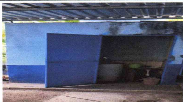
Foto 3: Sustrucción de puerta
