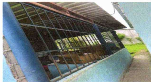
SEGUIMIENTO A BALCONES DE COCINA
