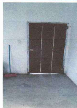
Foto 4: Sustrucción de puerta de aula
