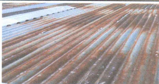
Foto 1: Pintura anticorrosiva de lamina del techo
