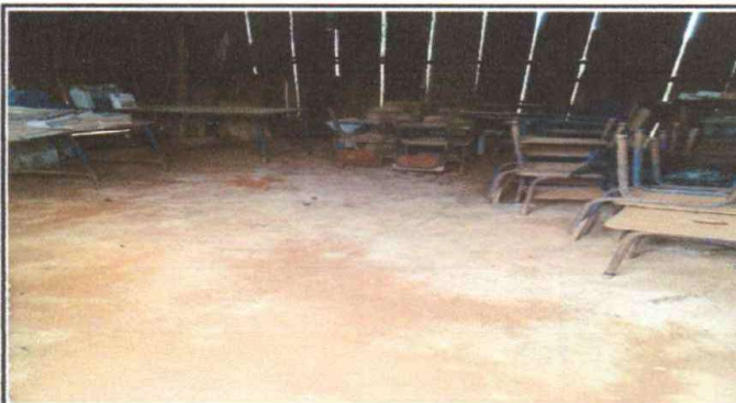
Foto 3: SUSITTUCION DE PISO DE TORTA DE CEMENTO
