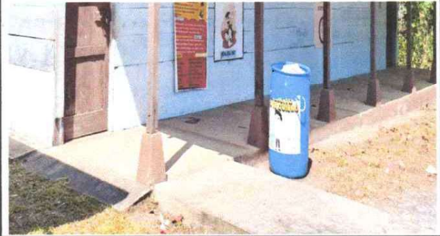
FOTO: Sustrucción de piso de torta de concreto
