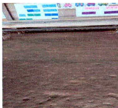
Foto 4: Sustrucción de piso de torta de concreto
