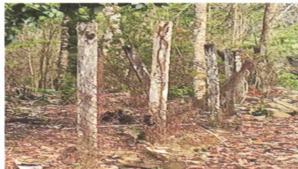
FOTO 2: Sustrucion soporte de madera por metal.
