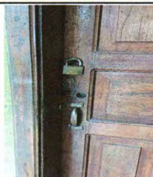
Foto 4: Sustrucción de chapa
