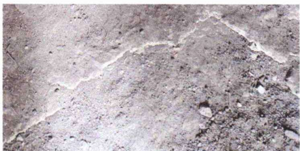
Foto 5: Sustrucción de piso de torta de concreto
