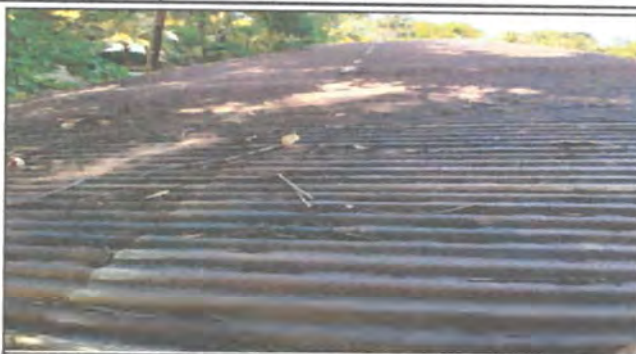
Lámina del techo de seis aulas corroida y con agujeros por el paso del tiempo.
