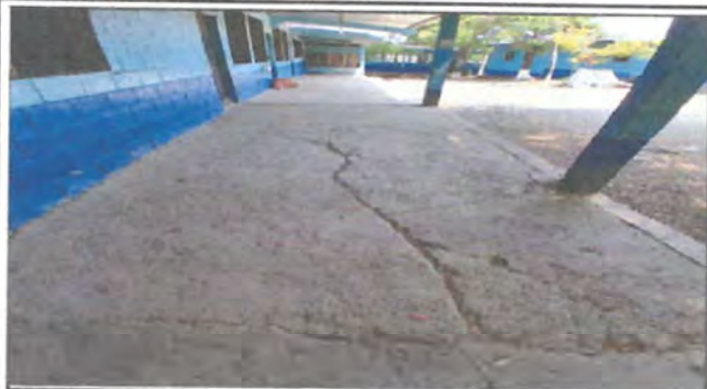
Piso del corredor de 6 aulas en mal estado por el paso del tiempo y la mala calidad de los materiales.
