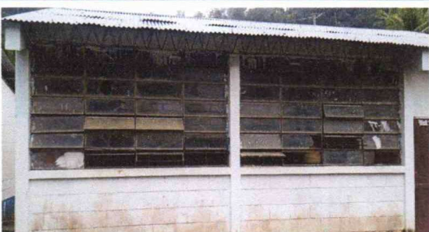
Foto 3: Sustrucción de persianas de vidrio por balcon de metal
