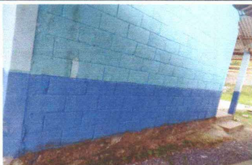
Foto 3: pintura en muros exterior
