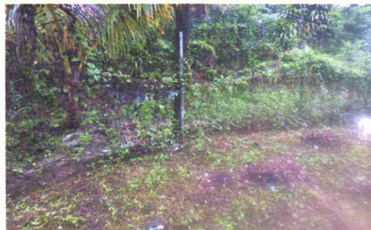
Foto 2: MALLA DE ATRÁS EN MAL ESTADO
