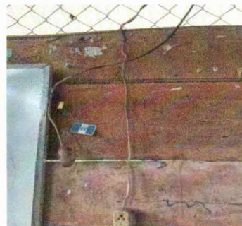
Foto 5: El cableado de una de las aulas esta en mal estado
