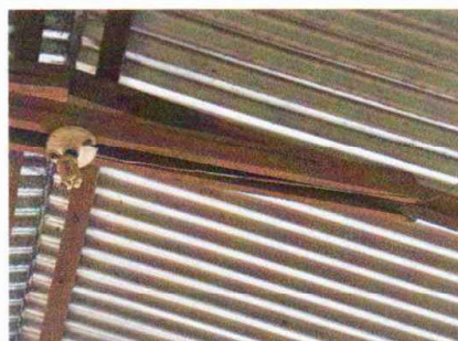
foto 6: El bombillo de una de las aulas esta quebrado.
