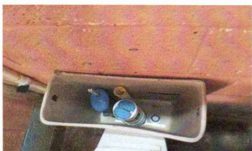
Foto 2: Se observa que esta dañado los accesorios de uno de los inodoros de los baños.
