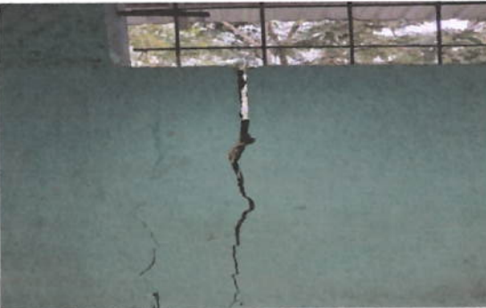
Foto 6: PARED CON GRIETAS
