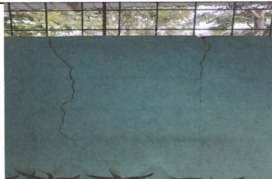
Foto 4: PARED CON GRIETAS
