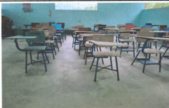
Foto 3: PISO EN MAL ESTADO
