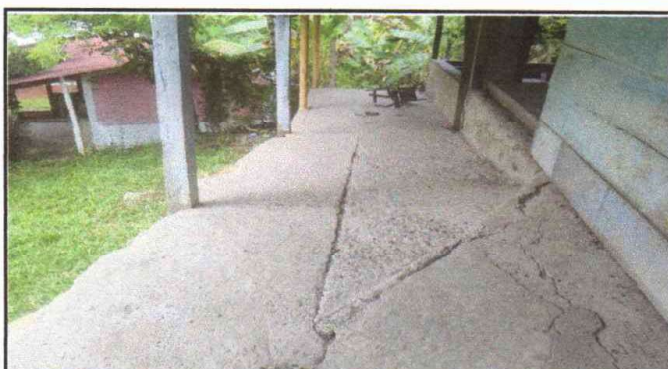
Foto 4: Piso en mal estado, agrietado.
