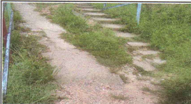
Foto 1: Gradas de la entrada en mal estado.
