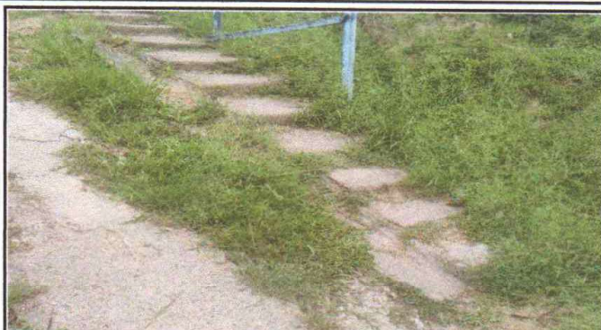
Foto 2: Gradas de la entrada principal en mal estado.
