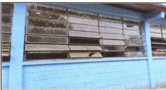
Foto 5: Ventanas en estado de oxidación.
