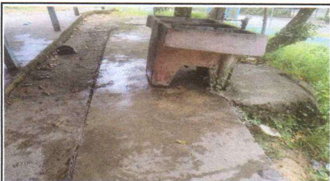
Foto 3: Piso en malas condiciones.
