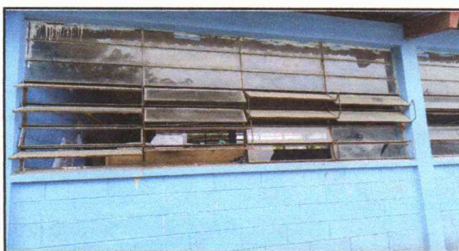
Foto 6: Ventanas en mal estados.
