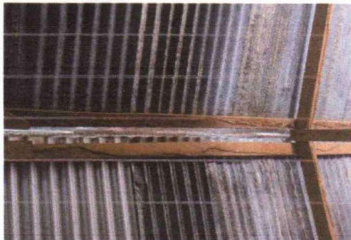
Estructura podrida y con comejen
