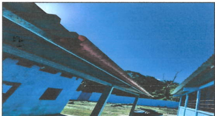
canales de pvc
