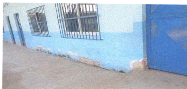
Foto 3: filtración de agua en todas las paredes de la escuela
