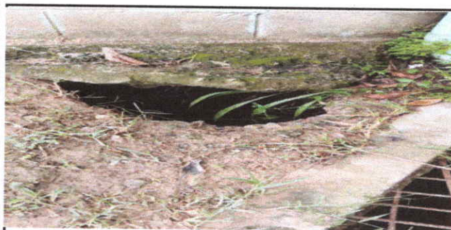
Foto 5: Socavamiento de la escuela.
