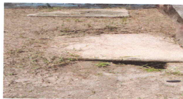
Foto 2: Fosa en mal estado
