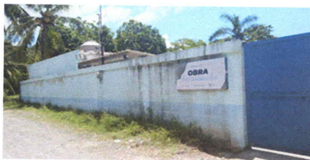
Foto 1: Pintura del muro perimetral exterior e interior entrada de la escuela en mal estado.
