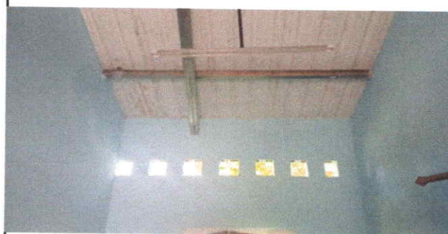
Foto 4: ventanillas abiertas por donde se entra en agua al llover.
