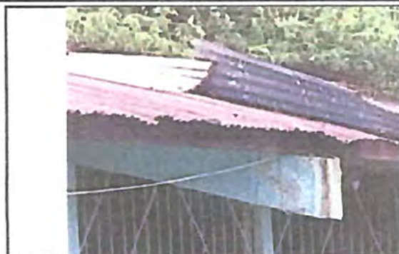
Foto 2: Deterioro total de la lámina del techo.
