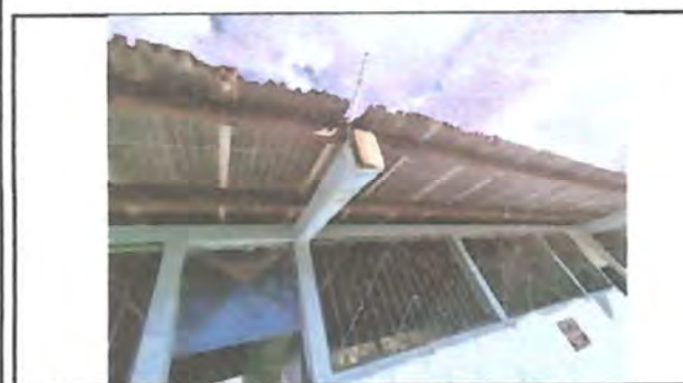
Foto 5: Deterioro total del techo. 3 aulas.
