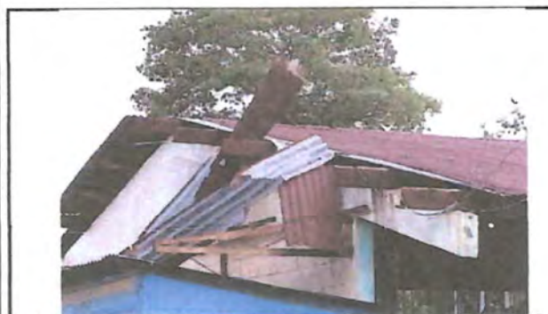
Foto 3: Las inclemencias del tiempo y el paso del tiempo, han destruido la lámina del techo.
