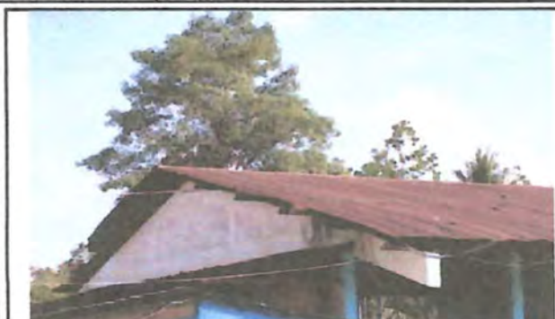
Foto 1: Techo en mal estado
